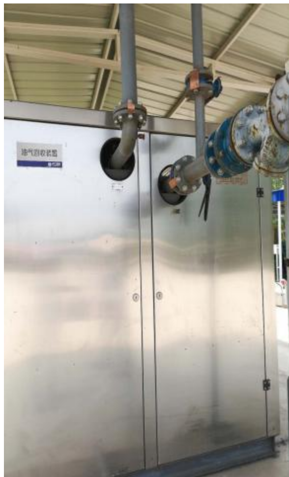
油气回收装置
