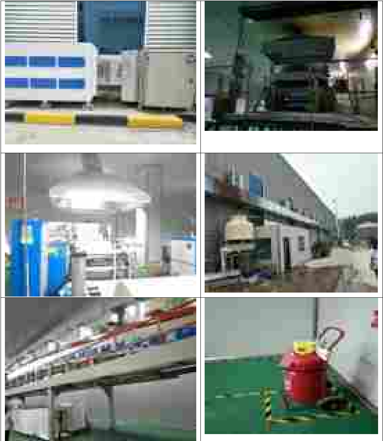
图 3：环保设备及现场采样照片
