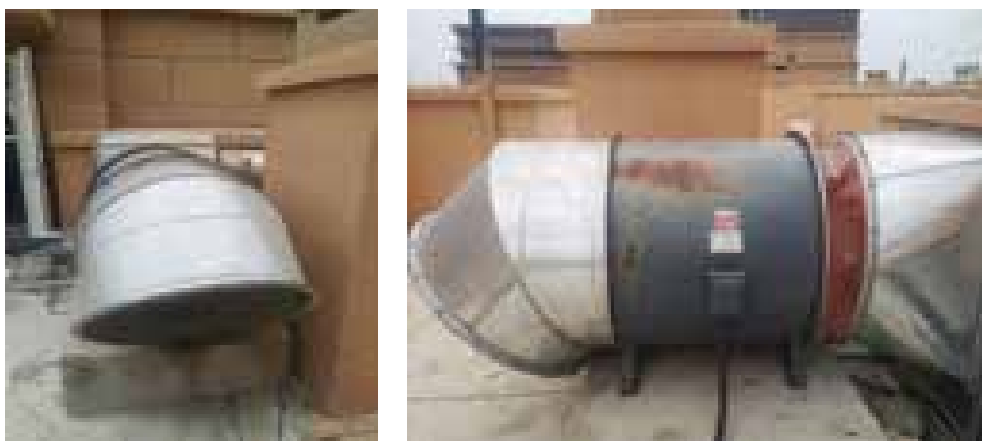
图 4-2 运营期废气治理设施照片
